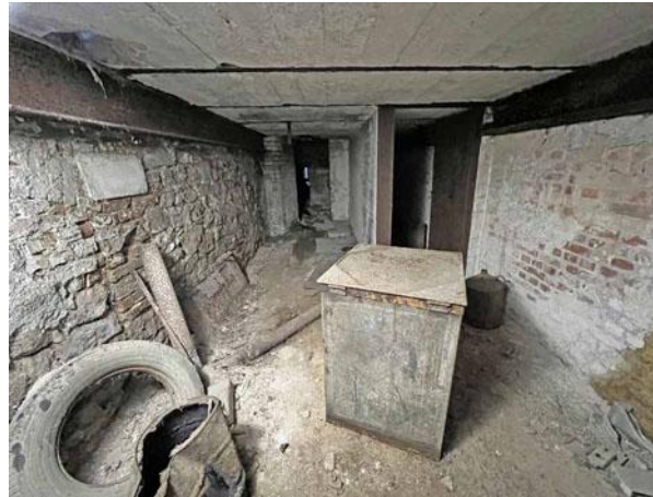
Abbildung 39: Raum im Turbinengebäude (Eigene Aufnahme 28.02.2023)
