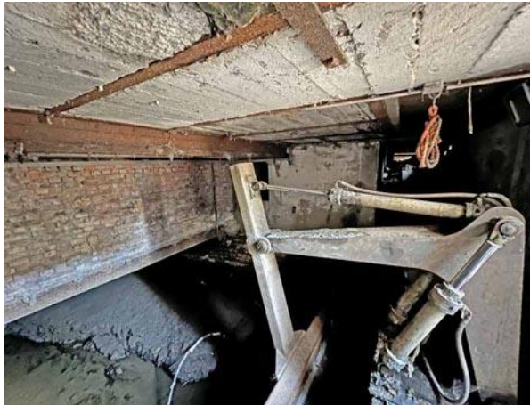
Abbildung 38: Mechanik im Zufluss des Mühlgrabens (Eigene Aufnahme 28.02.2023)
