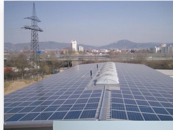
Photovoltaik auf dem Dach des Lagers
