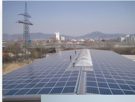
Photovoltaik auf dem Dach des Lagers
